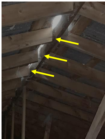
Chevrons mal fixés et détachés
