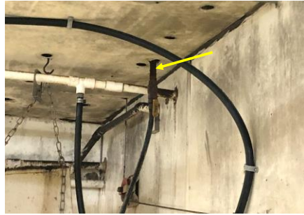
Descente de propane corrodée à remplacer
