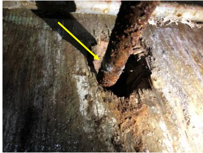
Conduite de gaz corrodée et percée
